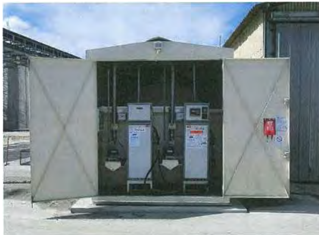
La station-service sur la zone I
